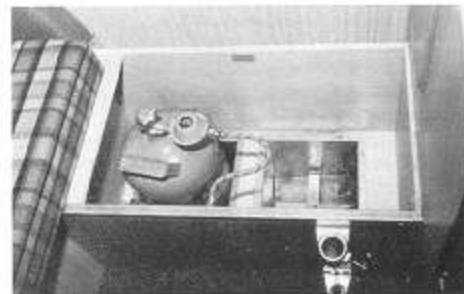
Gasanlage im seiti. Sitzkasten
